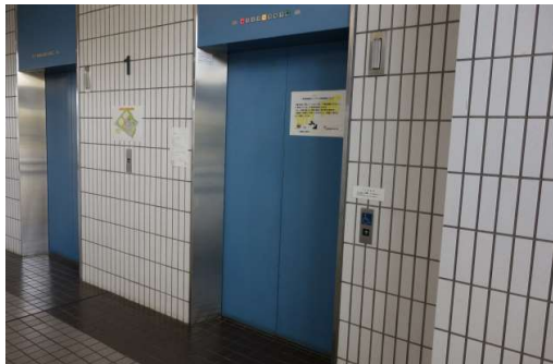
エレベータ 1号館正門側
